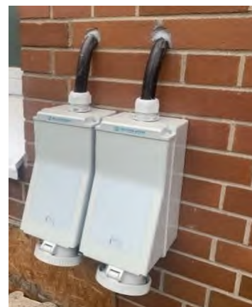
Künftig Standard: Notstromspeisung an THW-Gebäuden
