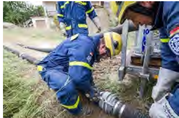
Pumpeneinsatz nach Unwetter
