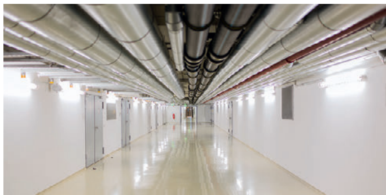
Camino a seguir: tuberías del sistema de suministro de energía económico y ecológico del barrio parlamentario.
