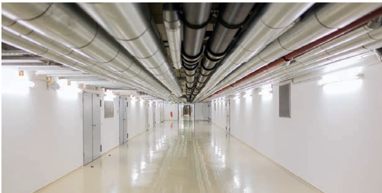
Przełomowe rozwiązania: Przewody zasilające energooszczędne i przyjazne dla środowiska urządzenia techniczne w dzielnicy parlamentarnej
