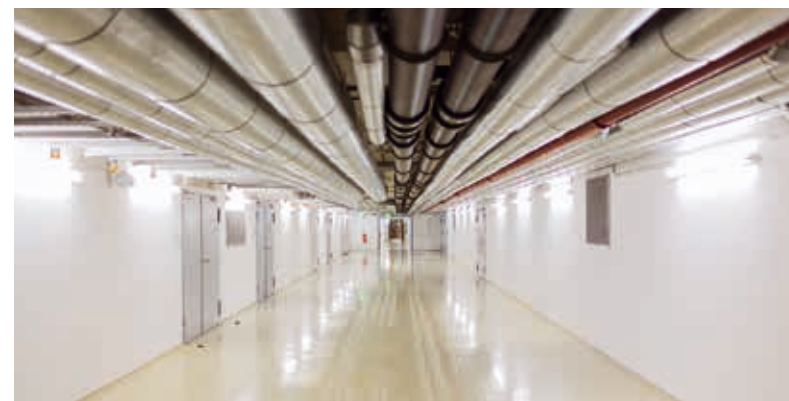
All'avanguardia: condutture di alimentazione per gli impianti del quartiere del Parlamento – ecologici e a basso consumo di energia.
